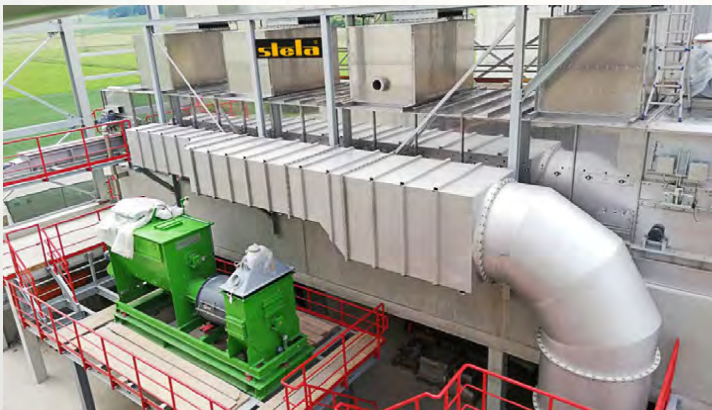
项目地：Schwenk Zement KG, 德国 | 型号：BTL 1/3000-14 | 安装年份：2020 干燥物料：RDF垃圾燃料 | 出料能力：约8.9吨/小时 | 降水区间：15% - 5%湿度
