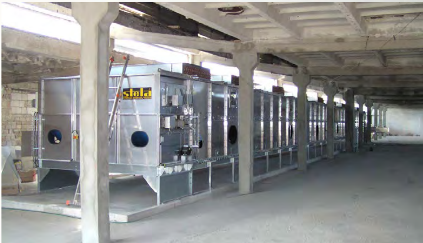
项目地：Z.U.O. Gorzow, 波兰 | 型号：BTL 1/3000-33 | 安装年份：2015 干燥物料：甜菜渣 | 出料能力：约1.2吨/小时 | 降水区间：77% - 12%湿度
