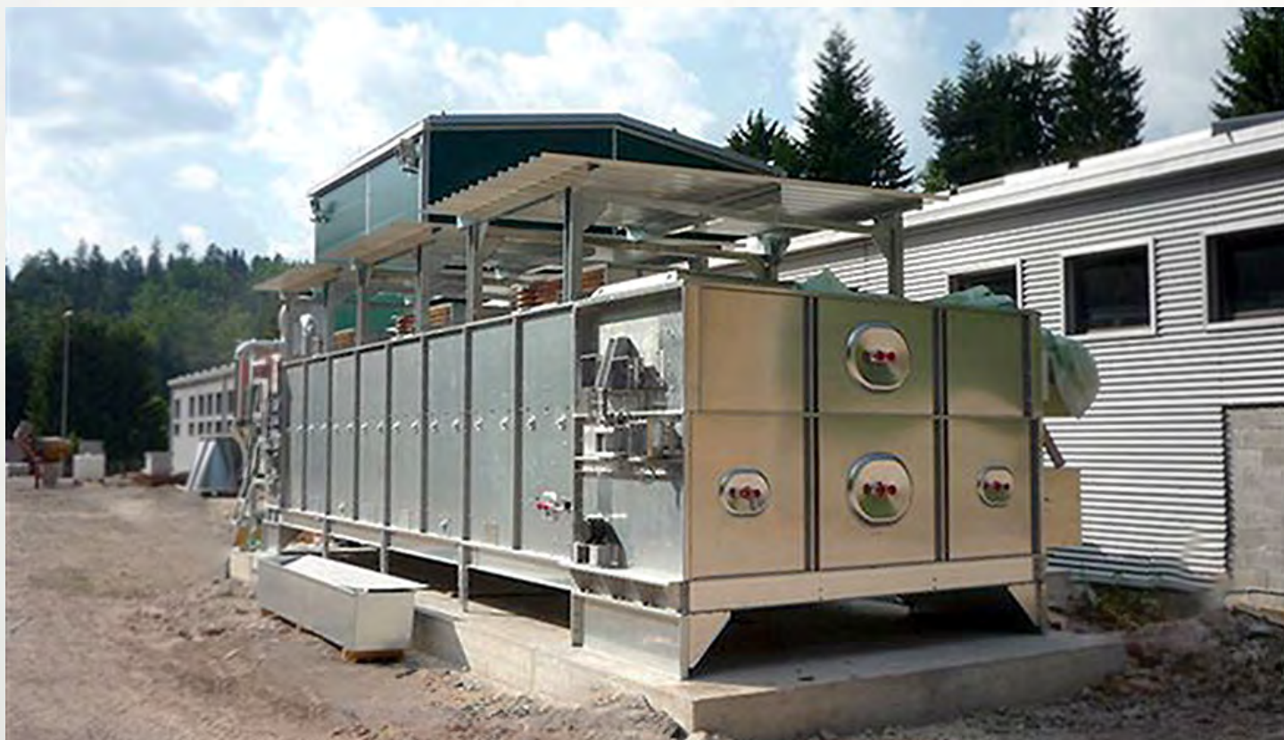
项目地：Orkan Energija doo, 克罗地亚 | 型号：BTL 1/3000-8 | 安装年份：2015 干燥物料：木片 | 出料能力：约1.1吨/小时 | 降水区间：50% - 20%湿度
