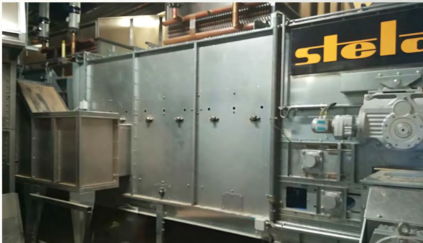
项目地：Lamprecht GmbH/SRL, 意大利 | 型号：BTL 1/3000-10 | 安装年份：2016 干燥物料：木屑 | 出料能力：约1.6吨/小时 | 降水区间：50% - 10%湿度
