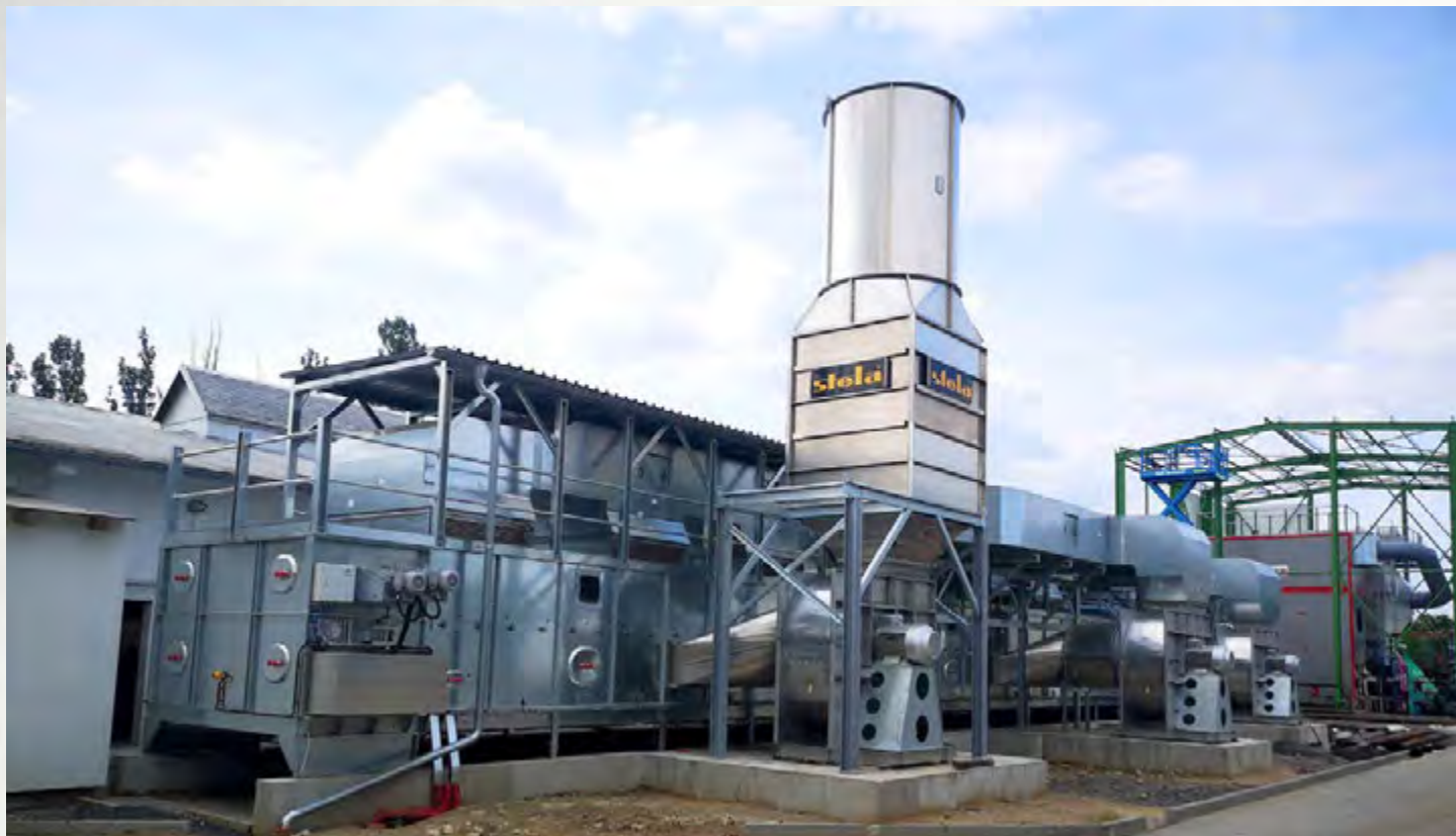
项目地：Premium Pellets s.r.o., 捷克 | 型号：BTLU 1/3000-30 | 安装年份：2020 干燥物料：木屑 | 出料能力：约4.5吨/小时 | 降水区间：50% - 12%湿度
