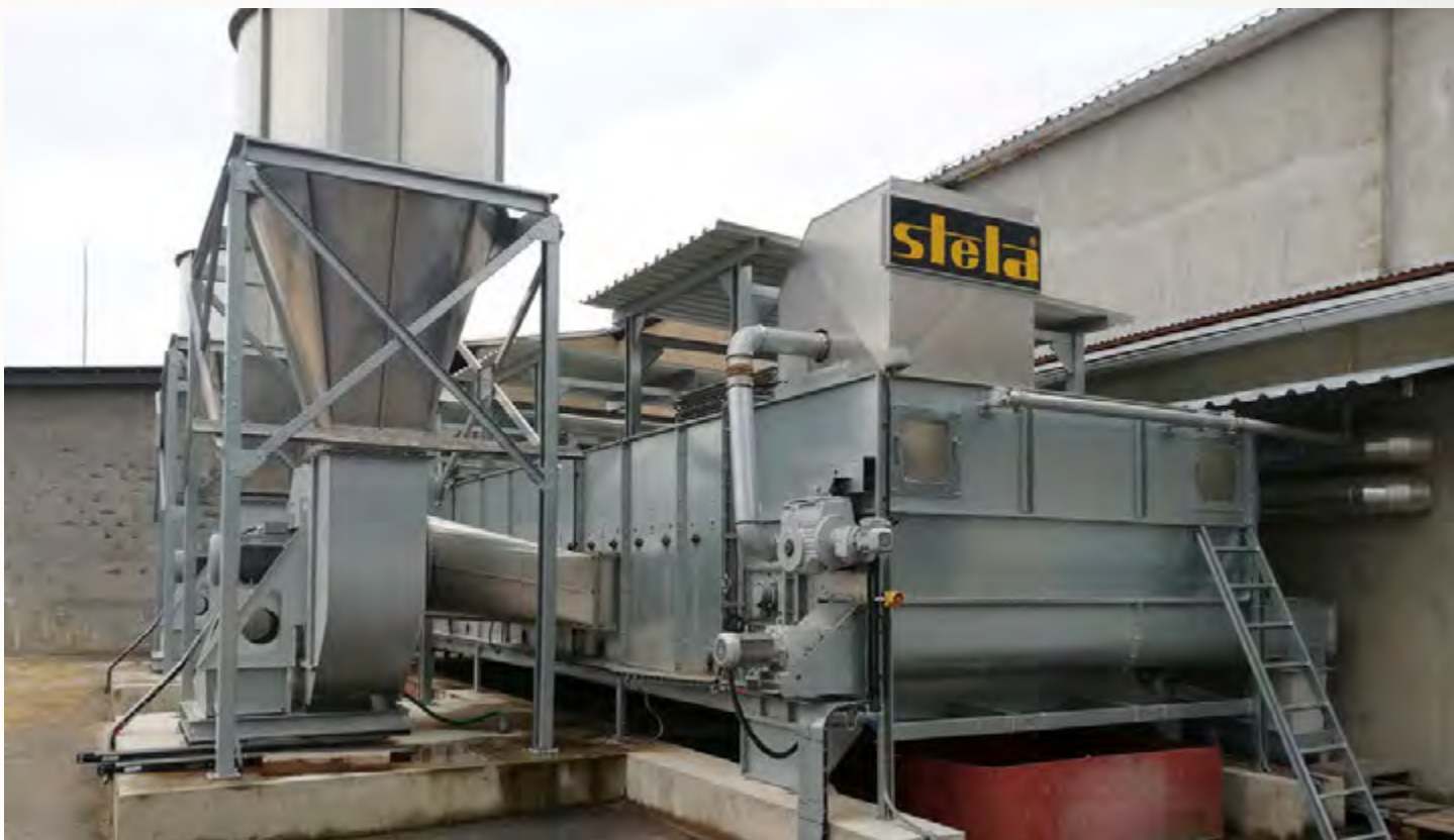
项目地：Rolnická a.s. Králíky, 捷克 | 型号：BTL 1/3000-14 | 安装年份：2018 干燥物料：木屑 | 出料能力：约2.37吨/小时 | 降水区间：50% - 12%湿度
