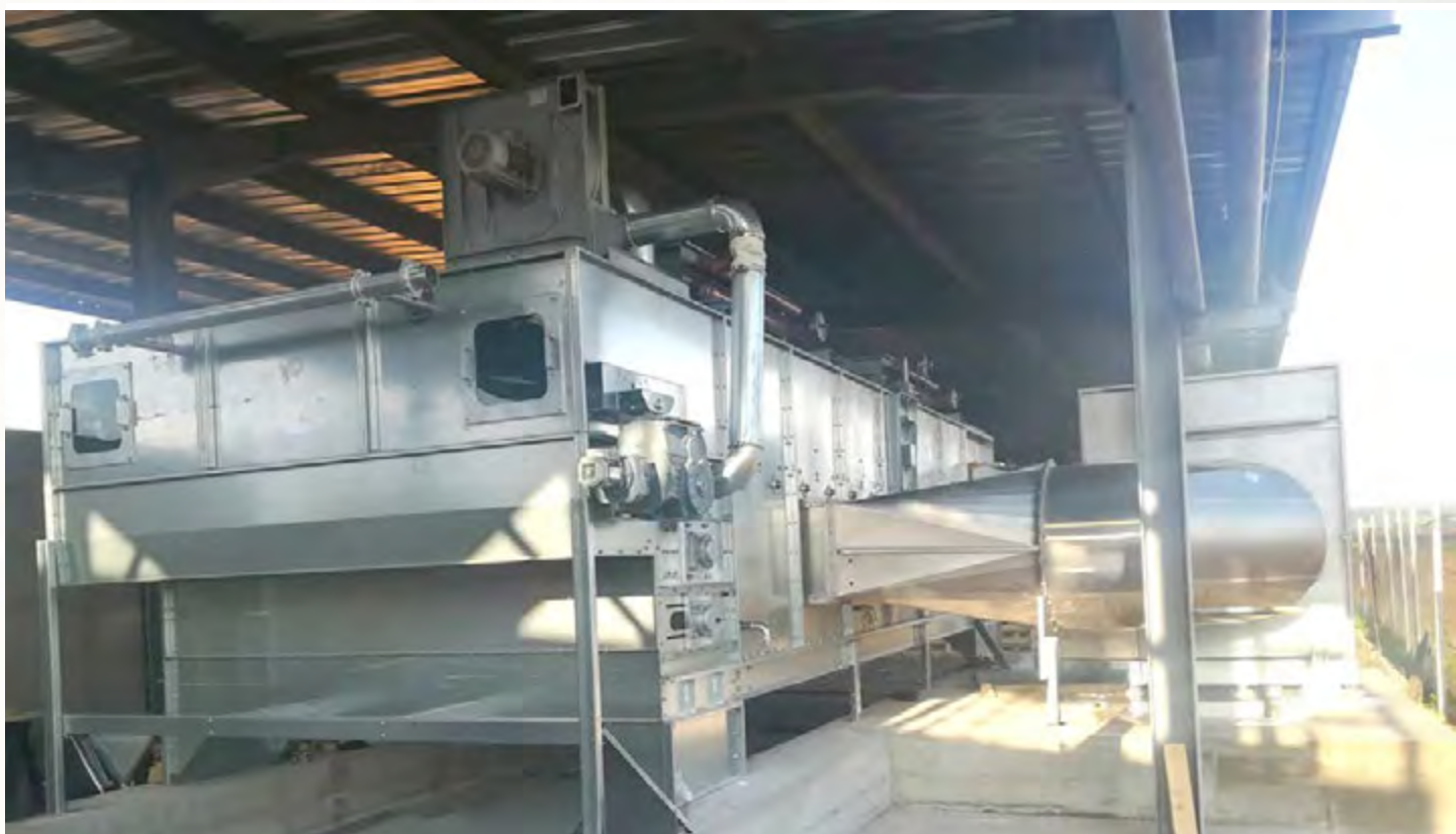
项目地：Haty srl, 罗马尼亚 | 型号：BTL 1/3000-6 | 安装年份：2022 干燥物料：木屑 | 出料能力：约1.0吨/小时 | 降水区间：55% - 10%湿度
