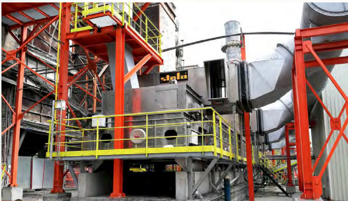
项目地：CRH, 罗马尼亚 | 型号：BTL 1/3000-25 | 安装年份：2019 干燥物料：SSW固废垃圾 | 蒸发量：最大3.3吨/小时
