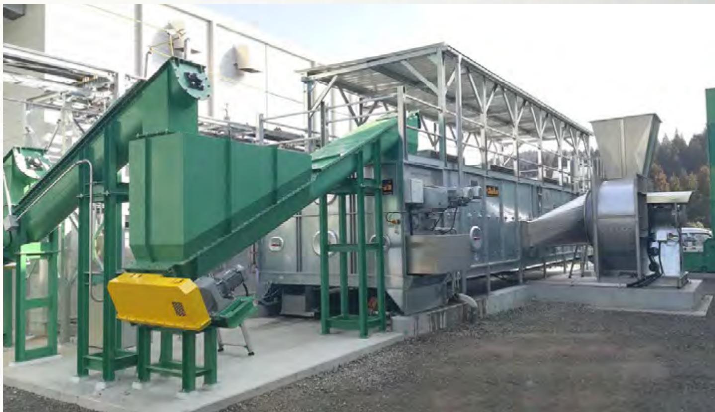
项目地：光洋电子株式会社, 日本 | 型号：BTL 1/3000-12 | 安装年份：2017 干燥物料：木屑 | 出料能力：约1.92吨/小时 | 降水区间：50% - 10%湿度
