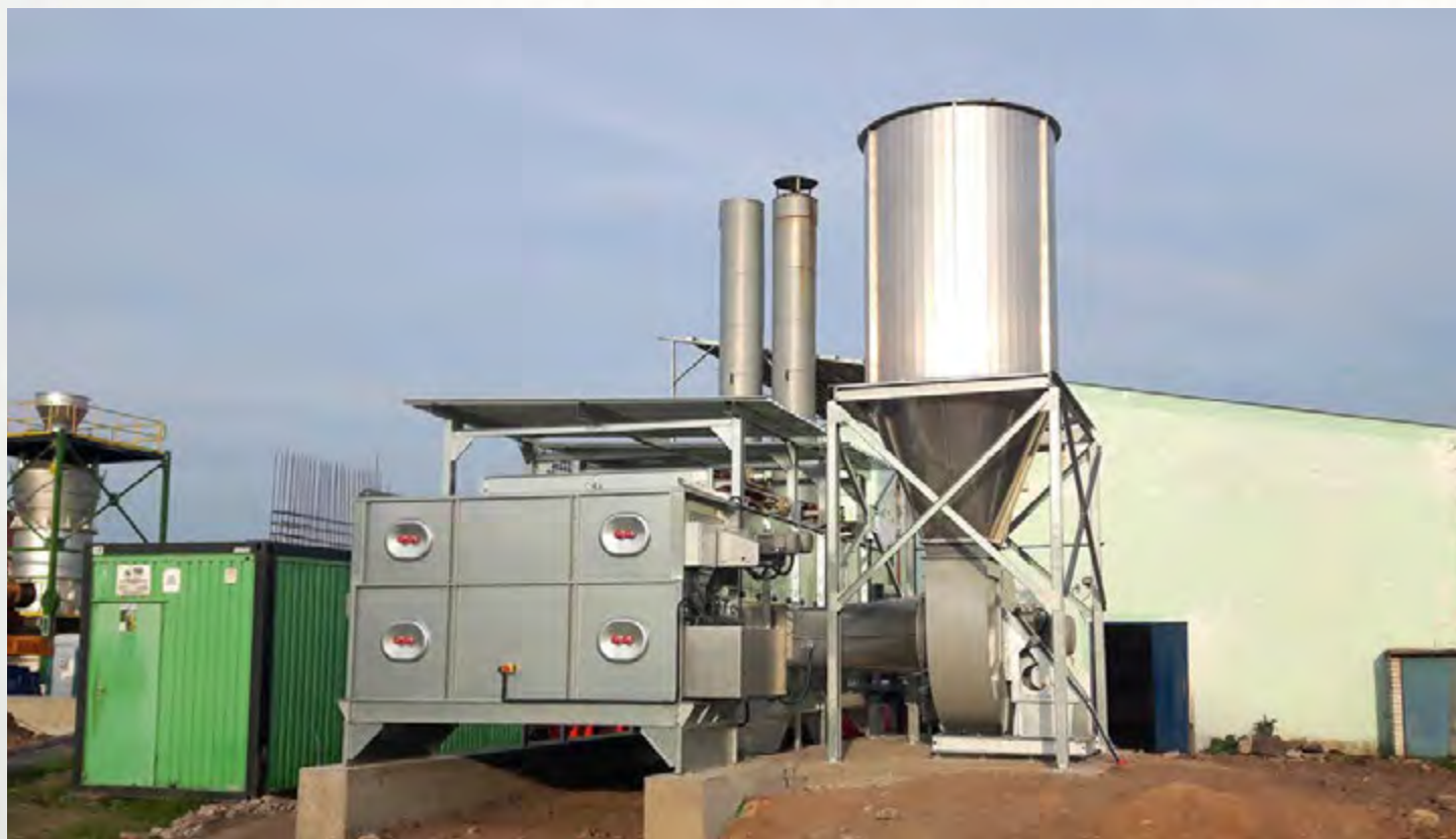
项目地：KGJ Dukla, 捷克 | 型号：BTL 1/3000-5 | 安装年份：2019 干燥物料：木片 | 出料能力：约0.68吨/小时 | 降水区间：50% - 20%湿度
