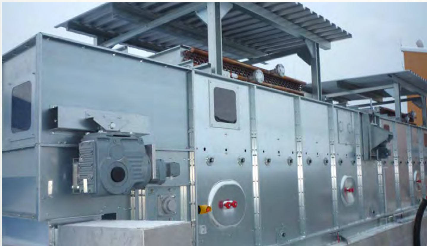
项目地: Pawlica Dnesice Cernotin, 捷克 | 型号: BTL 1/2000-9 安装年份: 2012 | 干燥物料: 消化污泥
