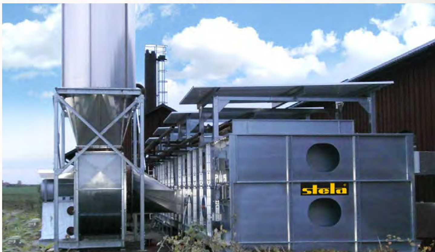
项目地：Loarp Energy AB, 瑞典 | 型号：BTL 1/3000-14 | 安装年份：2013 干燥物料：木屑 | 出料能力：约2.8吨/小时 | 降水区间：50% - 10%湿度
