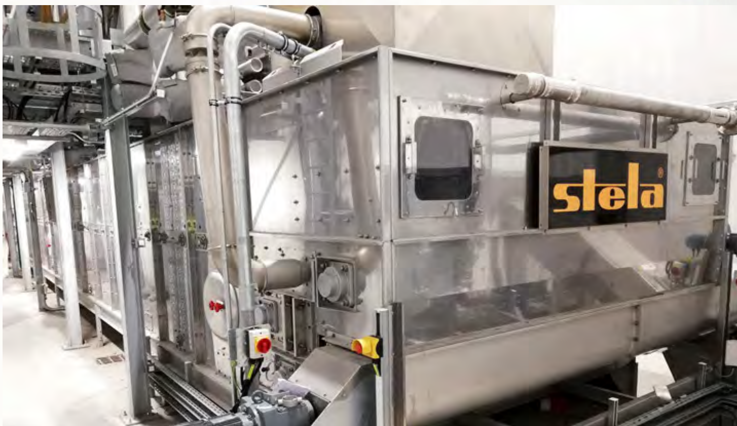
项目地：Jones Celtic Bio Energy, 爱尔兰 | 型号：BTL 1/3000-17 | 安装年份：2019 干燥物料：沼渣 | 出料能力：约1.67吨/小时 | 降水区间：75% - 49.5%湿度
