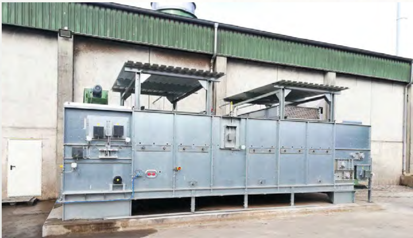
项目地：Borchers Kreislaufwirtschaft GmbH, 德国 | 型号：BTL 1/3000-6 | 安装年份：2021 干燥物料：木片 | 出料能力：约3.0吨/小时 | 降水区间：25% - 10湿度
