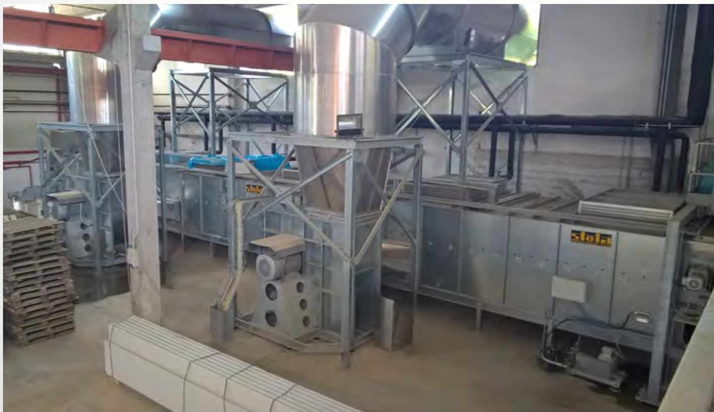
项目地：MORE d.o.o., 克罗地亚 | 型号：BTL 1/3000-22 | 安装年份：2014 干燥物料：木屑 | 出料能力：约3.3吨/小时 | 降水区间：50% - 12%湿度
