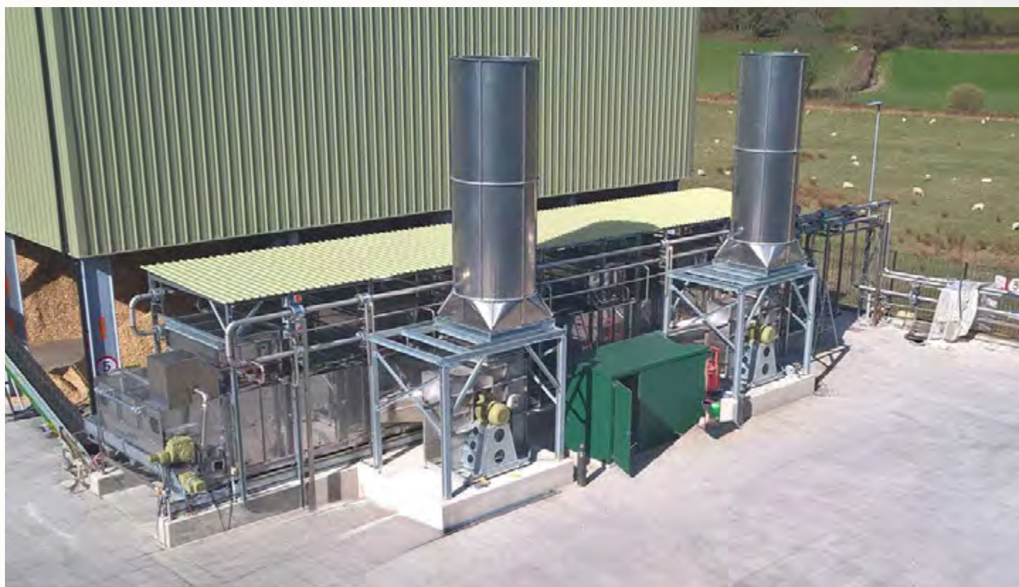
项目地：Volac International Ltd., 英国 | 型号：BTL 1/3000-22 | 安装年份：2017 干燥物料：木片 | 出料能力：约8.0吨/小时 | 降水区间：55% - 40%湿度
