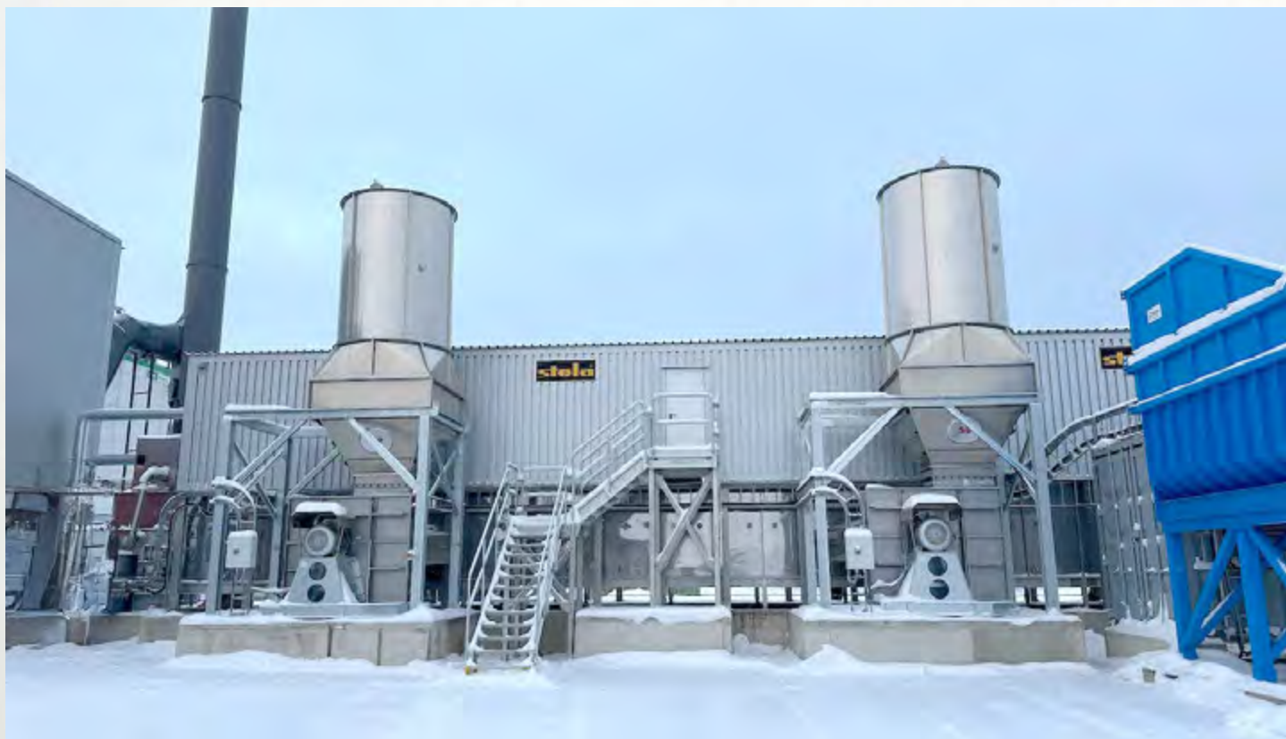
项目地：Vara Saeveski OÜ, 爱沙尼亚 | 型号：BTL 1/3000-20 | 安装年份：2023 干燥物料：树皮 | 出料能力：约3.1吨/小时 | 降水区间：75% - 50%湿度
