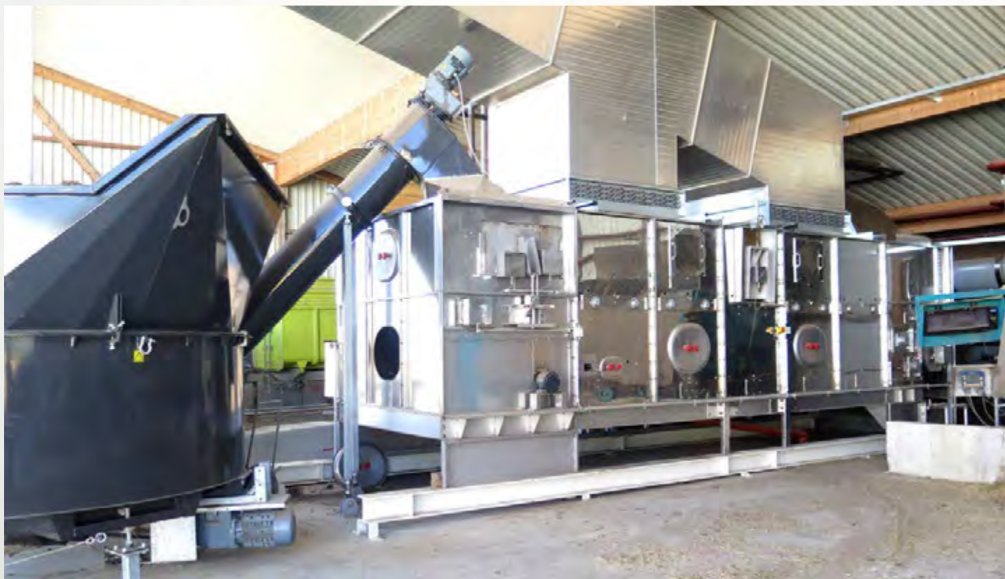
项目地：Martin & Maria Wotzinger, 德国 | 型号：BTL 1/2000-5 | 安装年份：2016 干燥物料：消化污泥 | 出料能力：约69公斤/小时 | 降水区间：76% - 15%湿度
