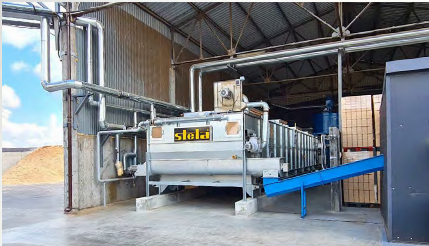
项目地：SkyFy Pallets, 乌克兰 | 型号：BTL 1/3000-14 | 安装年份：2020 干燥物料：木屑 | 出料能力：约4.5吨/小时 | 降水区间：40% - 10%湿度
