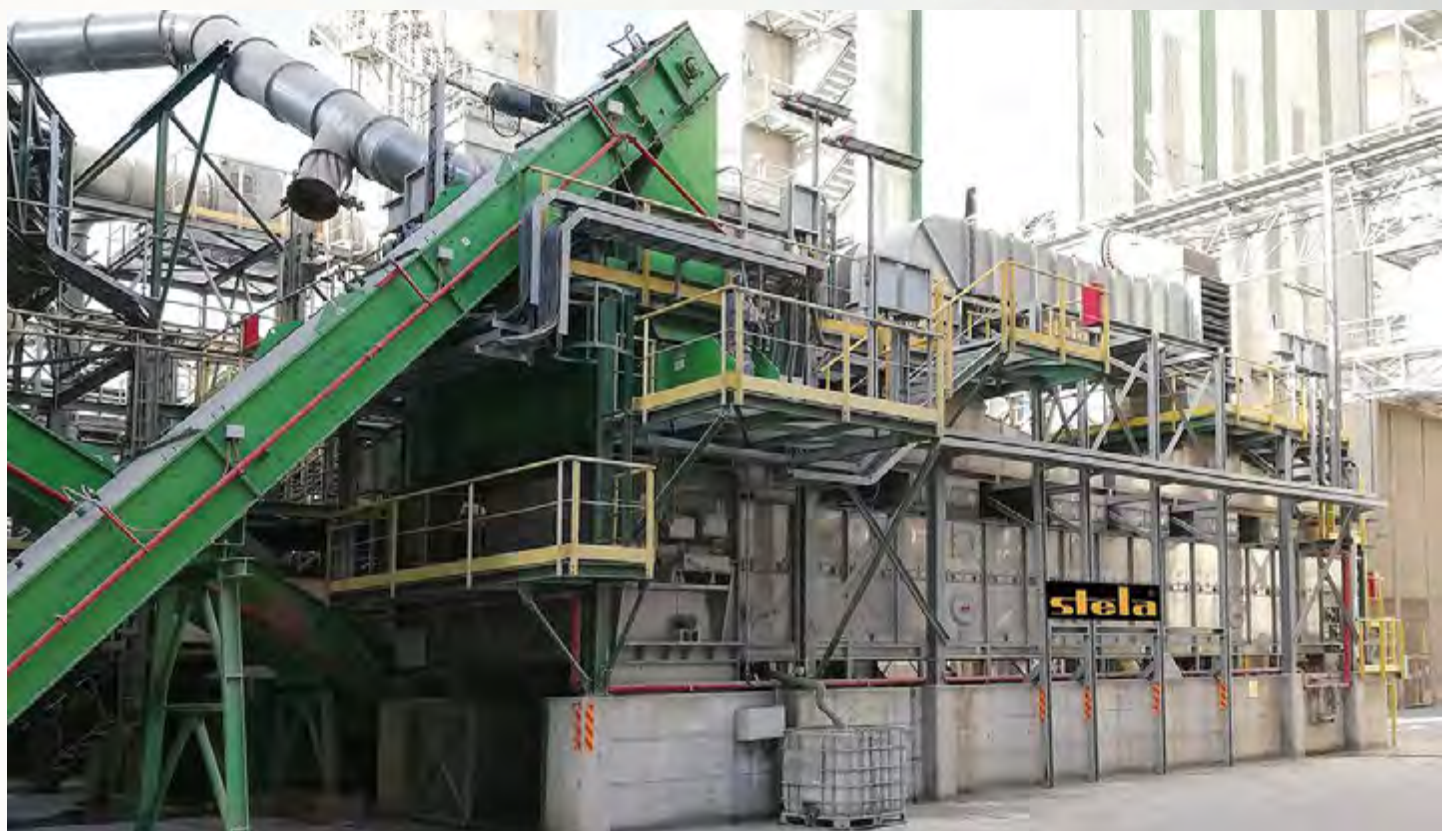
项目地：Nesher Israel Cement, 以色列 | 型号：BTLU 1/3000-16 | 安装年份：2018 干燥物料：RDF垃圾燃料 | 蒸发量：最大1.7吨/小时
